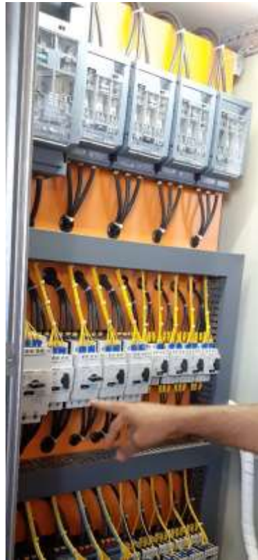
Figura 07 – Painel de controle dos espaços confinados Fonte: Próprio Autor (2019)
